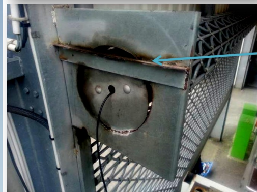
L'axe est décroché du carter, une soudure précaire a été réalisée
