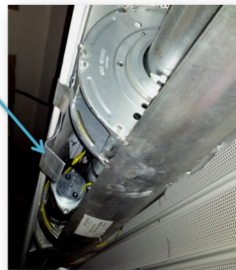
La chaînette est détachée du carter maintenant l'axe du rideau métallique
