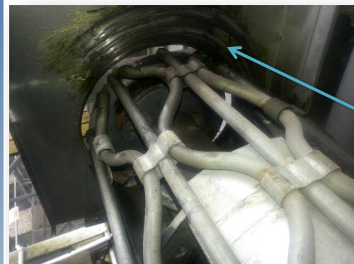
L'axe du rideau est détaché de sa structure porteuse
